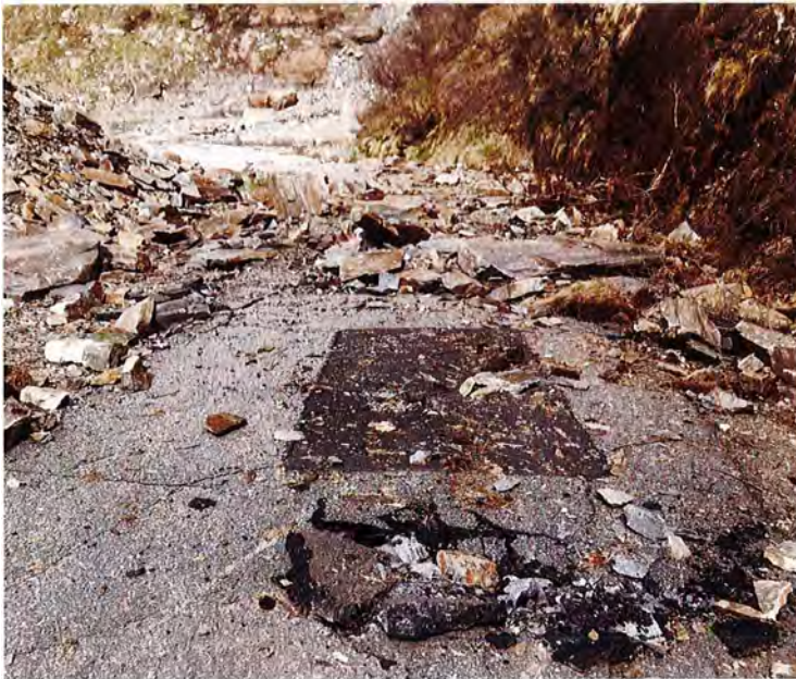
Figura 3: La tratta di strada fortemente danneggiata.
